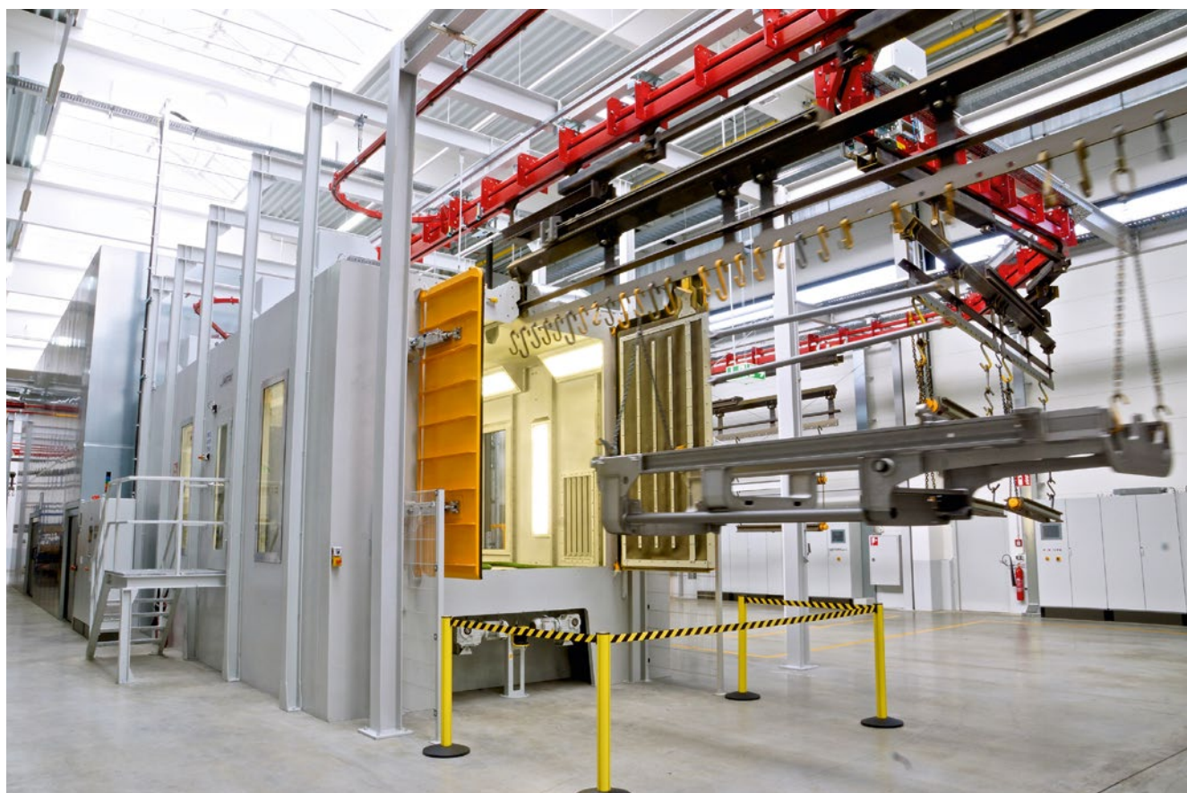
Przelotowa oczyszczarka strumieniowa z transportem podwieszonym (Jungheinrich, Moosburg, Niemcy).
